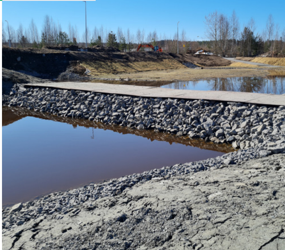
Den færdige dæmning filtrerer vand før udledning.
