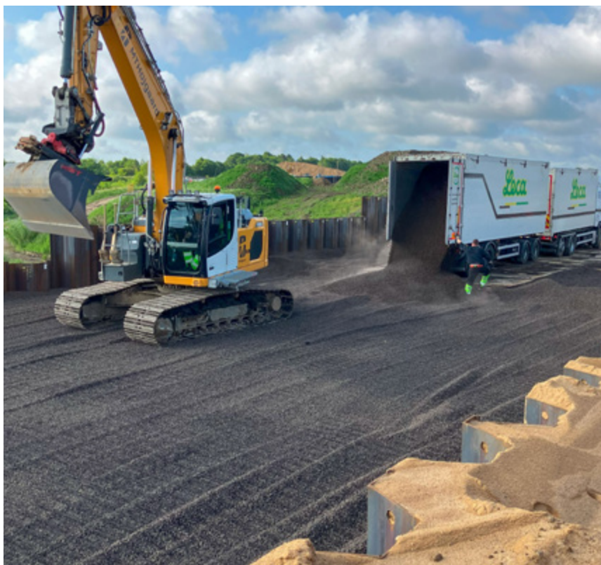
Leca® letklinker udlægges på motorvej E45 – hvilket reducerer belastning og jordtryk i vejkonstruktionen.
