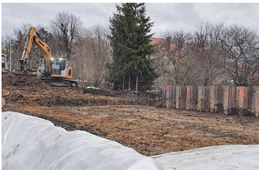
En beskyttelse af sporlekronen blev konstrueret i form af en holdekonstruktion af en sektionforankret stålspunsvæg.
